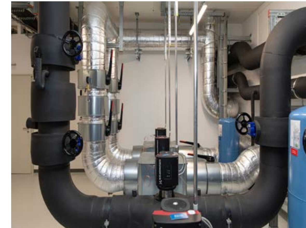
Pumpenhaus an Hauptsitz in Oberschleißheim
